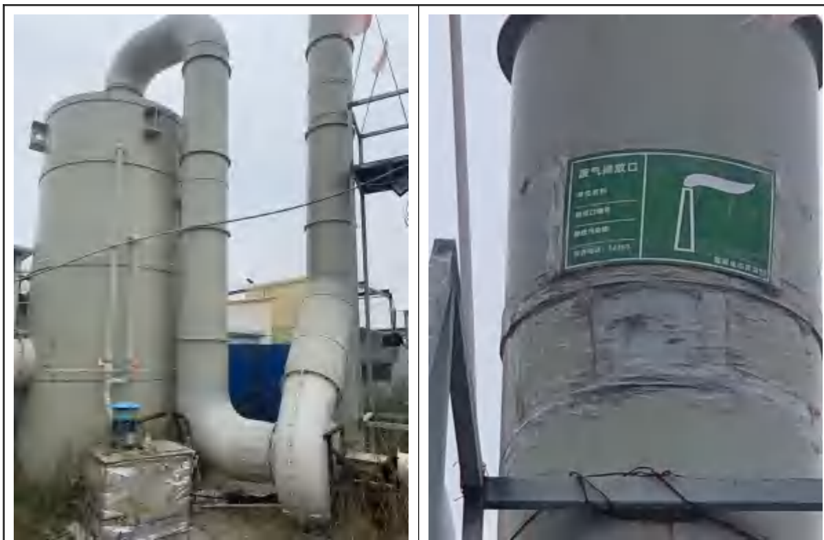
图 3.1-2 废气治理设施
